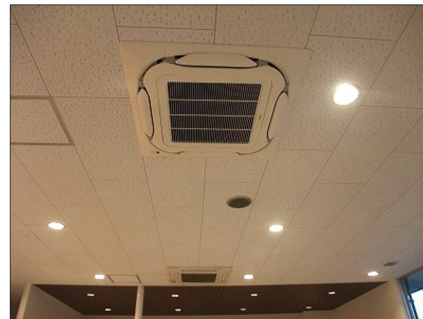
ショールーム系統・室内機天カセ4方向 機器更新後(ダイキン製昇降グリル付)
