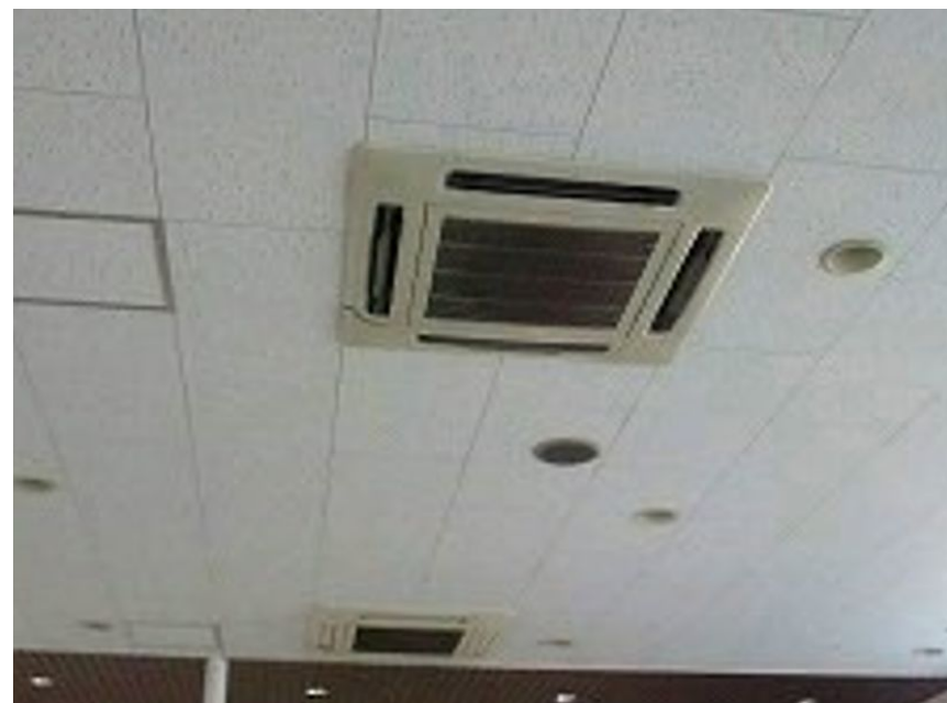
ショールーム系統・室内機天カセ4方向 機器更新前
